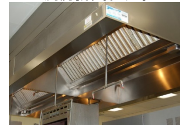
厨房排気ダクト
